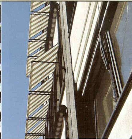
So schön sie an der Fassade auch wirken, werden Markisoletten nicht regelmäßig gereinigt, hinterlassen sie einen wenig einladenden Eindruck.
